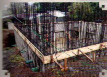
Vista frontal del tanque de 400m 3 .
