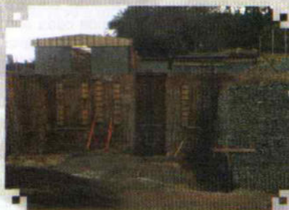
Tanque de 50 m 3 y estación de Bombeo en Bajo Rodríguez.
