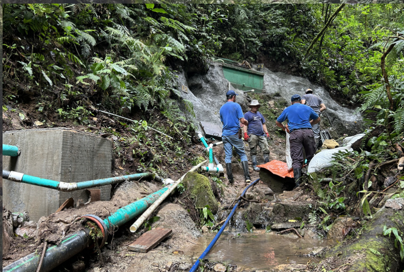
Area con múltiples captaciones y tubería de conducción.
